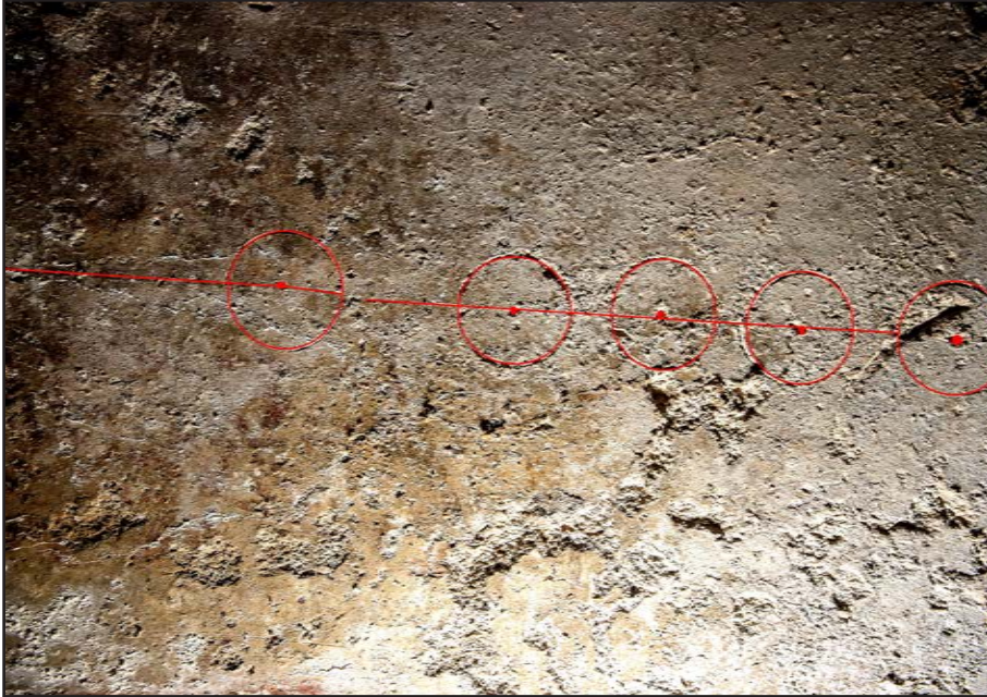
fig. 9 - Napoli, Via San Severo a Capodimonte n. 61. Particolare della decorazione pittorica: cerchi incisi (foto M. Palumbo; rielaborazione grafica di M. Amodio).
